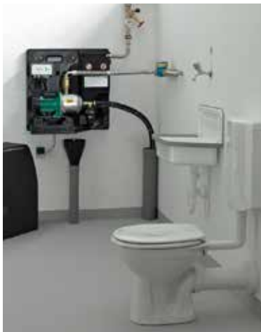
Einsatz des Wilo-RainSystem AF Comfort – Regenwassernutzung aus einer Zisterne.
