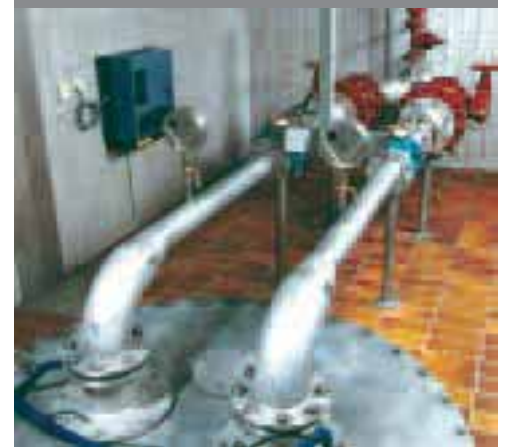
Double pump station Estación de bombeo doble
