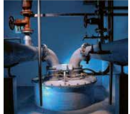
Well cover, vertical well at the pumping station Cabeza de pozo, pozos verticales en la estación de bombeo
