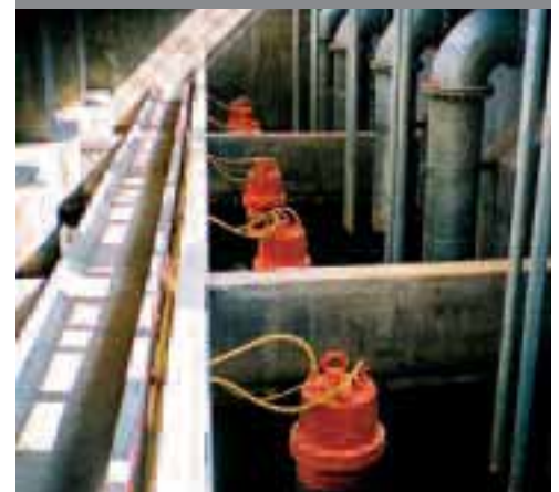
Application in storm water retaining basin for a surface of 10 ha Application d'eau bassin à eau pluviale pour une surface de 10 ha
