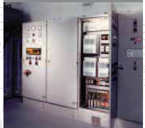
Accommodation of latest electrical equipment L'emplacement d'équipement électrique pourrier
