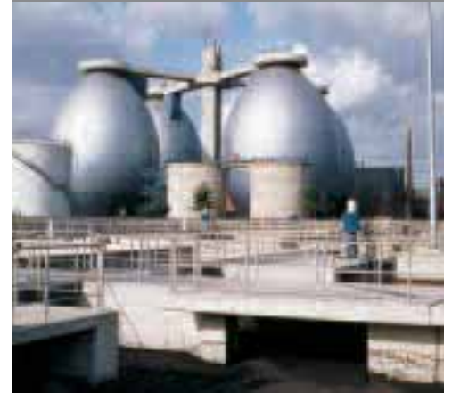
Sewage treatment plant Bottrop pour stations d'épuration Bottrop
