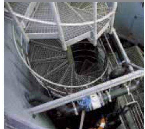
PEHD-pumping station with winding stairs Station de pompage PEHD avec escalier à vis
