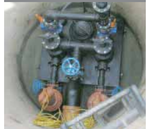
PEHD-pumping station in concrete pit Station de pompage PEHD dans puisard en béton
